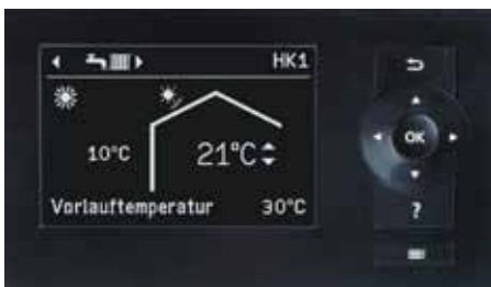
Display på värmepumpreglering Vitotronic 200
